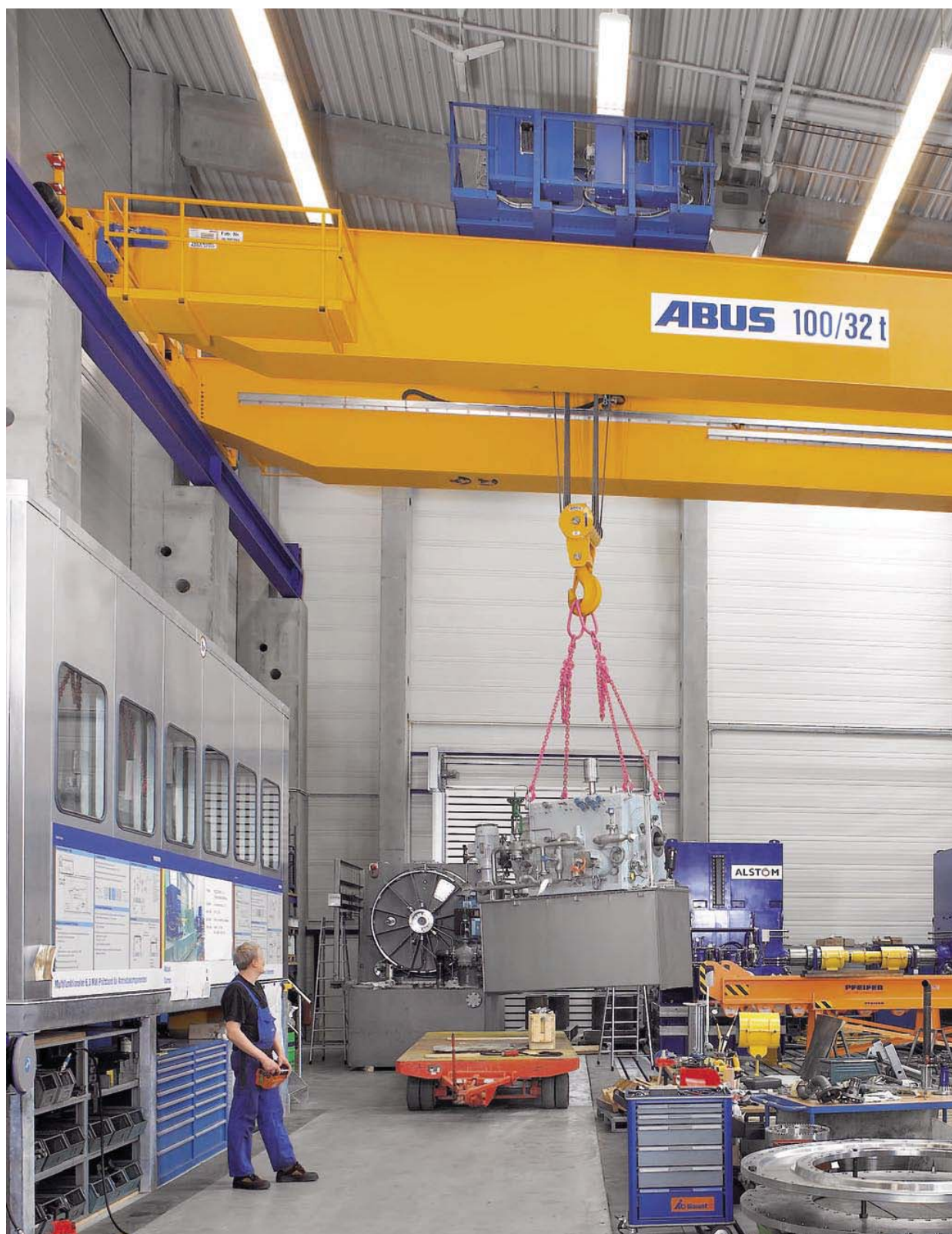
Pod rulant bigrindă ABUS ZLK cu două electropalane cu cablu, utilizat în montarea subansamblor grele ale mașinilor unelte
