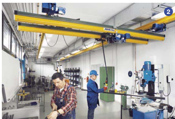
Sistemul ABUS ZHB cu două grinzii portante, utilizat într-un atelier de reparații
